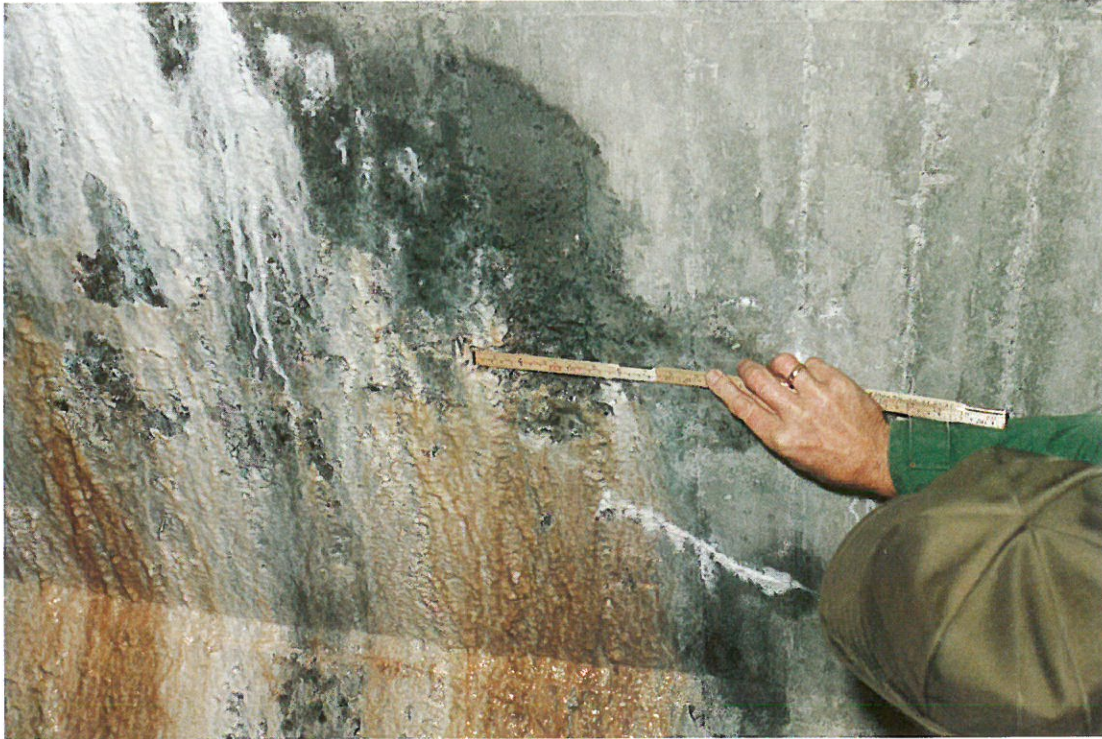
Figur 2 Kalkutvasking fra riss i en damplate
