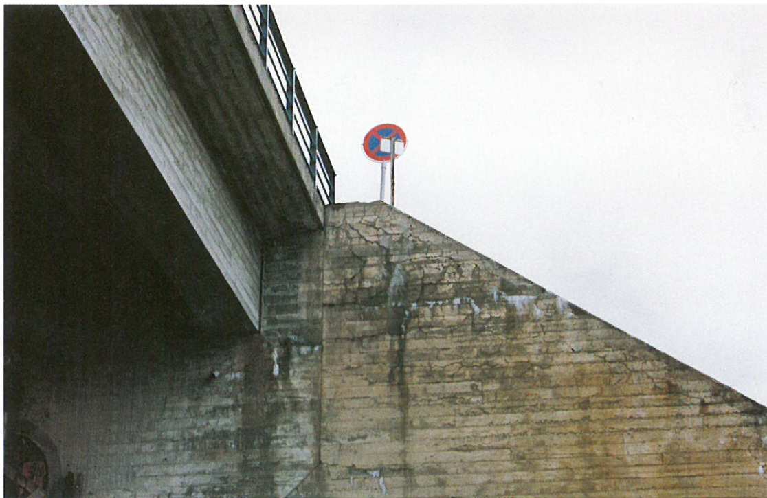
Figur 5 Oppsprekking pga. alkalireaksjon
