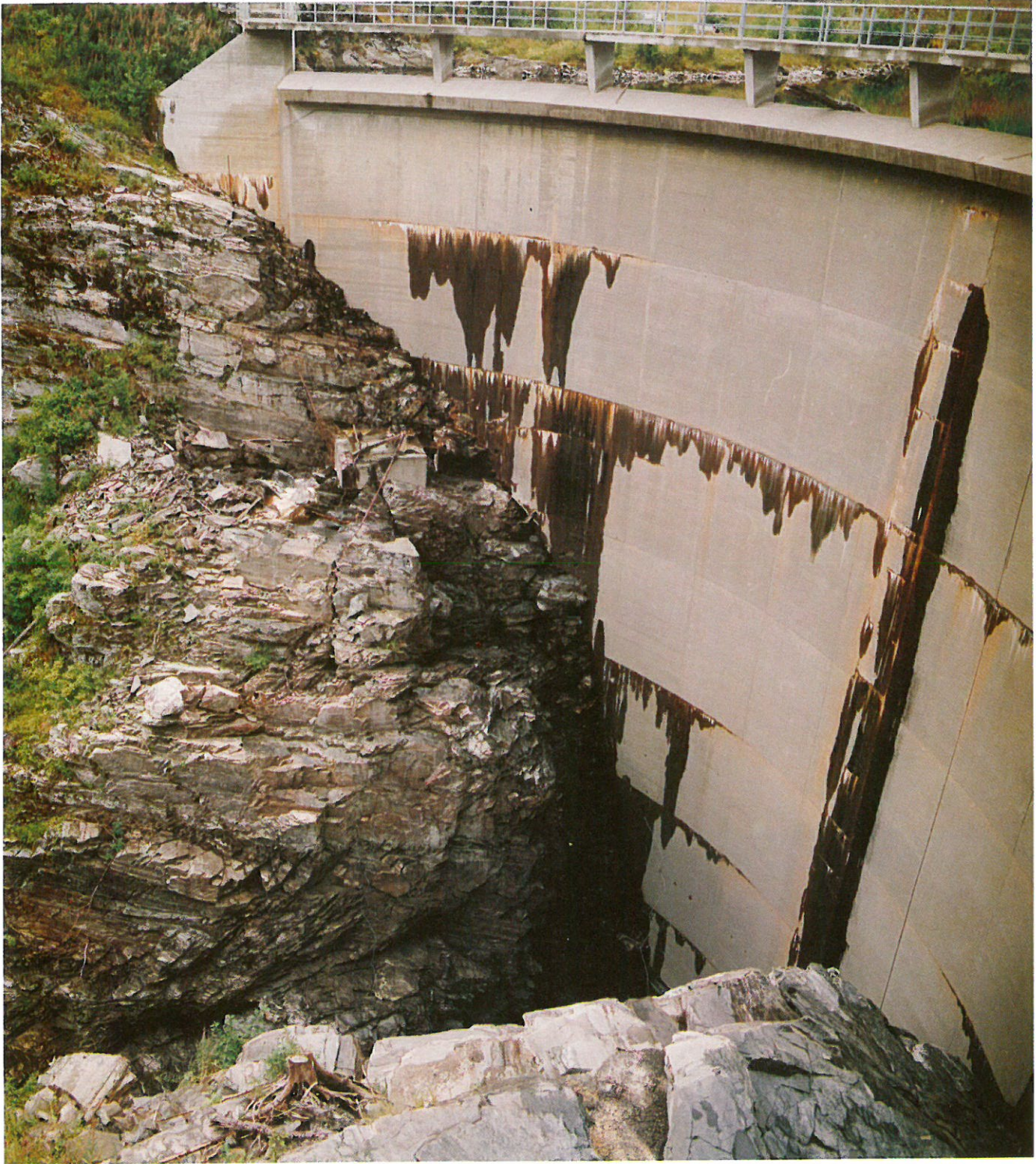
Figur 1 Lekkasjer i horisontale støpeskjøter og i riss i en hvelvdam
