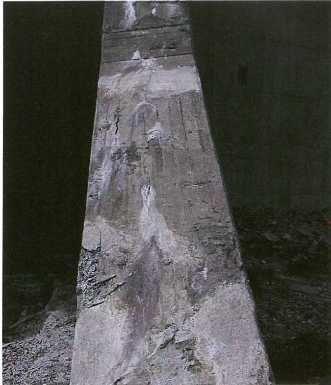
Figur 4 Sprekker i nedstrøms kant av pilar
