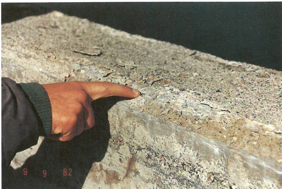
Figur 3 Avskalling (frostsprenning) på topp av brystning
