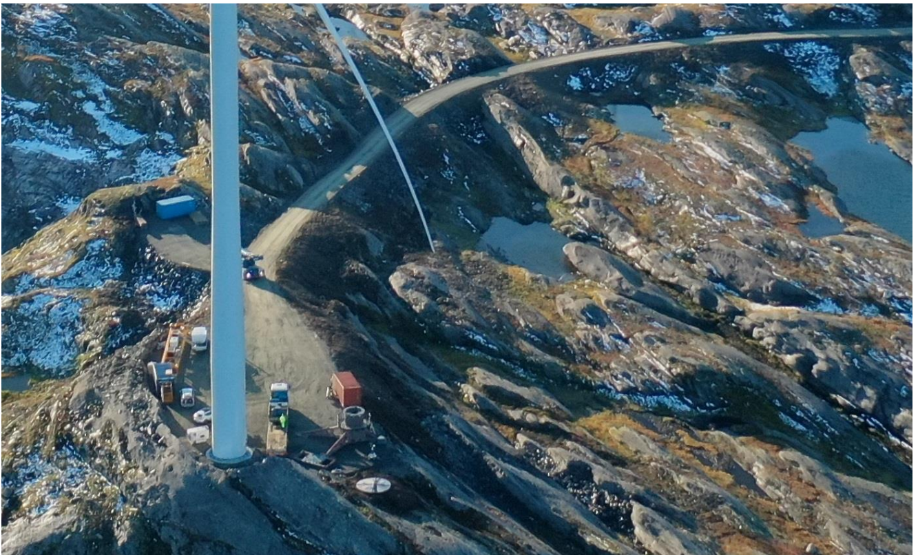
Figur 6-11: Forholdsvis små skjæringer og fyllinger som følge av liten veibredde på 4 meter og godt terrengtilpassete kranoppstillingsplasser.
