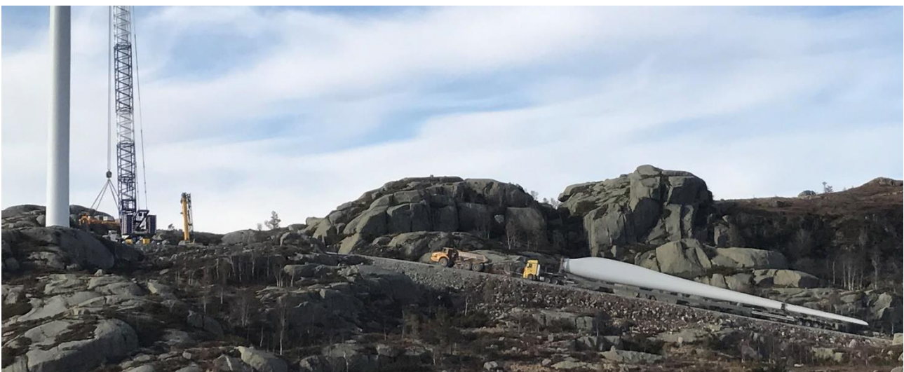
Figur 6-2: Transport av turbinblad med dumper som ekstra trekkraft på en bratt stikkvei på 20% stigning. I dette svært kupert terrenget hadde det vært nødvendig med store skjæringer og fyllinger om man hadde ønsket å bygge en mindre bratt vei.
