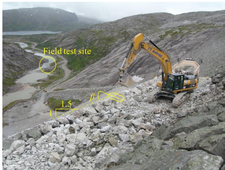
Figur 2 Arbeider på den 129 m høye dam Svartevatn. Gravemaskinen holder på å legge plastring på nedstrøms skråning med 1:1,5 som tilsvarer S = 0,67 . Helningsvinkelen \beta av plastringssteinene er indikert. Området for feltforsøkene (beskrevet i Kapittel 3.2) er merket med en sirkel (Foto: NTNU).
