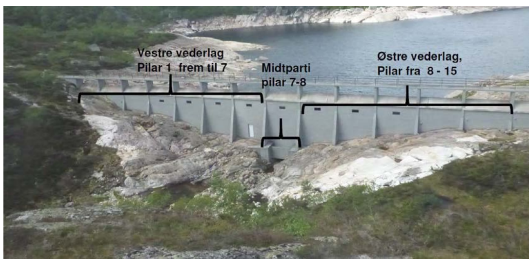
Figur A17. Betong platedam med 15 pilarer. Pilar 2 og 5, nr 2 og 5 fra venstre, er ansett som de mest kritiske
