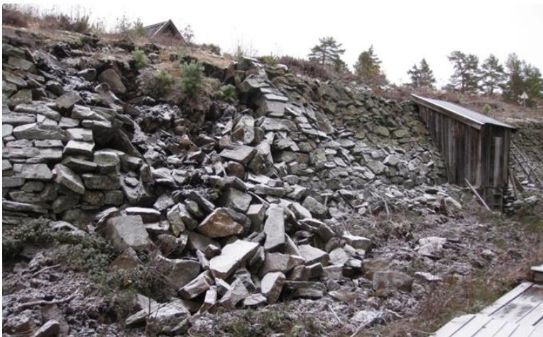
> Figur 8-5. Utrasing av nedstrøms mur i 2009.
