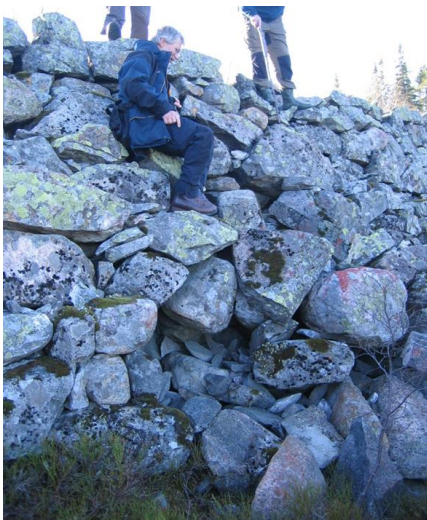
> Figur 8-7. Mur med instabilitet, utbuling og deformasjon.
