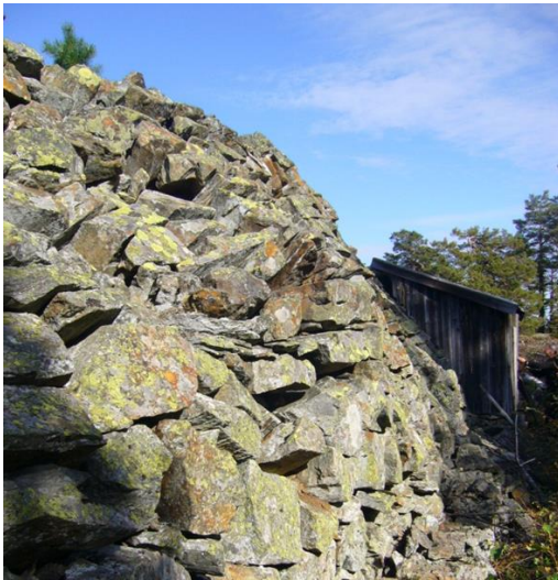
> Figur 8-4. Utbuling av nedstrøms mur før utrasing.
