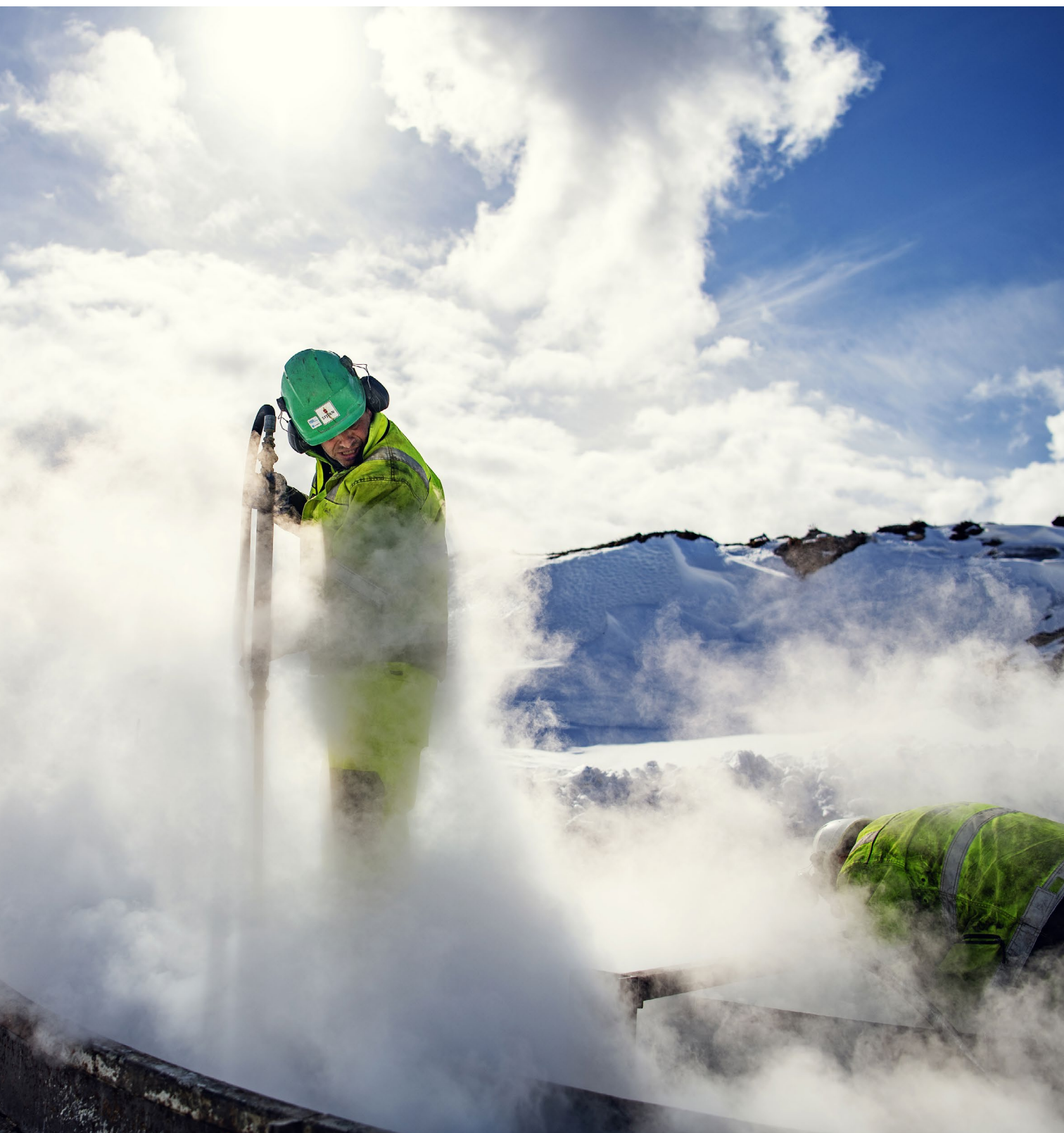
Utbyggingen av Roan kraftverk på Fosen.
